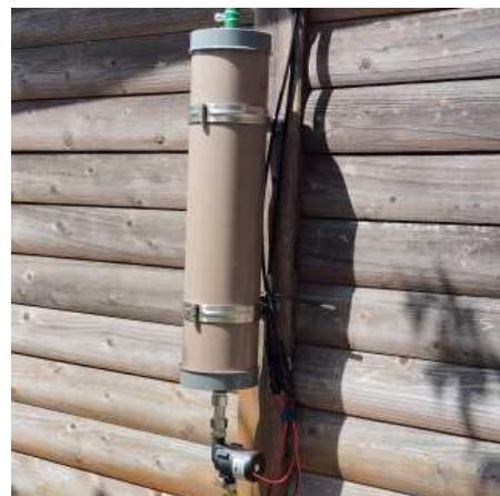
図7 温水循環タンク
